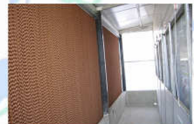
DETALLE DEL INTERIOR DEL COOLING
