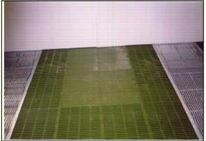
SUELO REJILLAS PARTOS CON SLATS TRIANGULAR EN MADRES Y PLASTICOS PARA LECHONES
