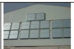
Ventilación tipo Túnel (vista exterior)
