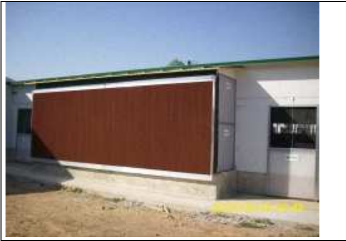
COOLING PARA VENTILACION TIPO TUNEL
