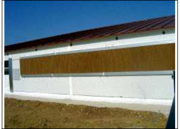
COOLING REFRIGERADOR CORRIDO
