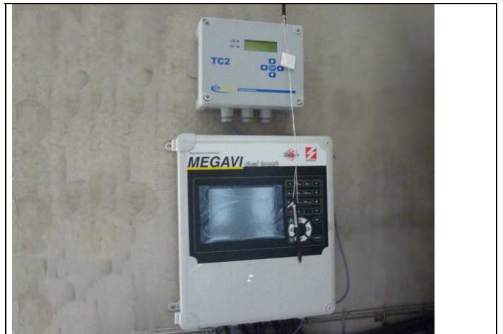
DETALLE DEL ORDENADOR MEGAVI Y DE LA ALARMA
