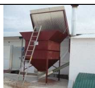
Tolva combustible Generador
