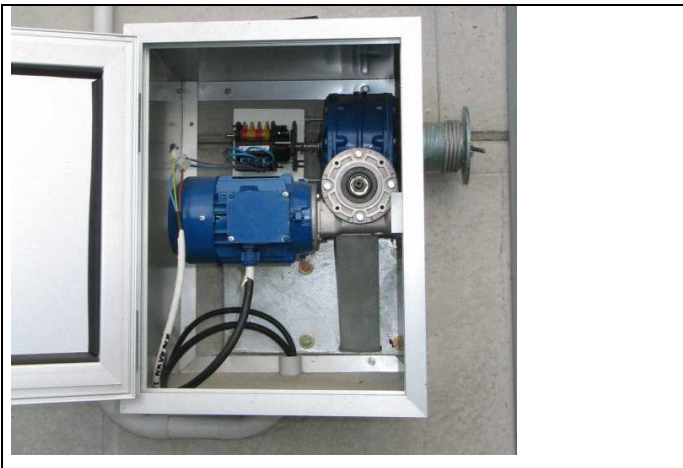
DETALLE DEL INTERIOR DEL ARMARIO CON EL MOTORREDUCTOR Y FINAL DE CARRERA
